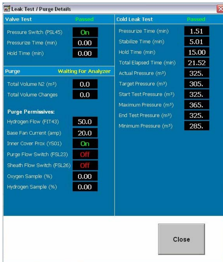
圖 14 洩漏測試沖氮及詳細狀態螢幕頁面
