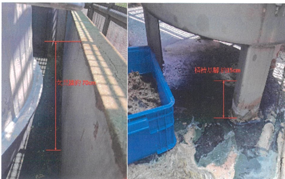
圖 2. FRP 塗層上折處標示
