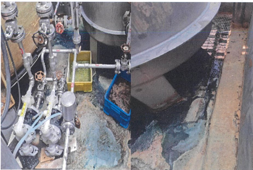
圖 1. 槽區內耐酸鹼地面表層破損處
